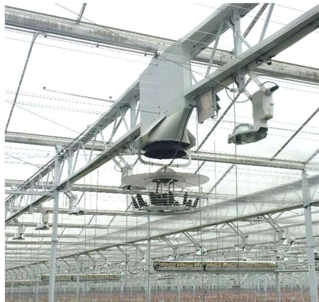
Ventilation Jet screen fan
